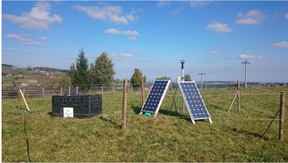
Figura 3. Echipamentele instalate la unul dintre elementele array-ului (cutia neagra contine microbarometru, data logger-ul Reftek RT 130, o baterie pentru alimentarea echipamentelor)
